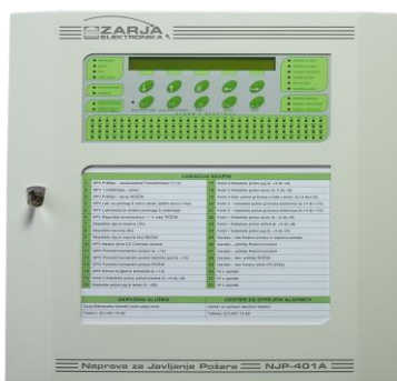
Slika 19: Požarno javljalna centrala
