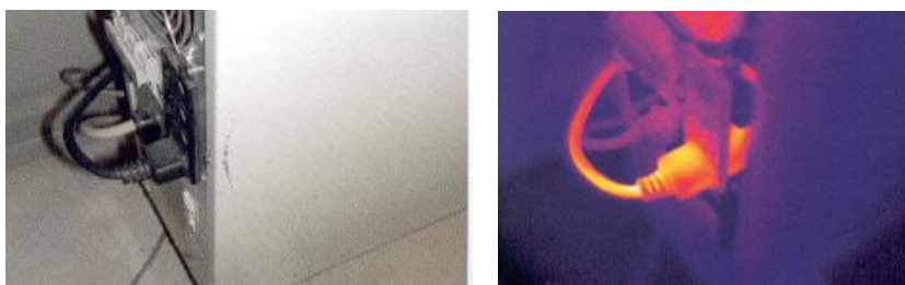
Slika 3: Slab spoj napajalnega kabla pri računalniku (Vir: Terming termografija d.o.o.)
