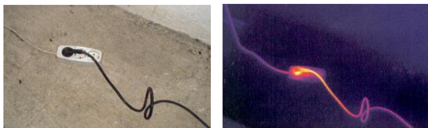
Slika 4: Slab spoj na preobremenjenem napajalnem kablu (podaljšek) (Vir: Terming termografija d.o.o.)
