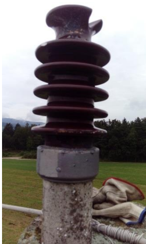
Slika 19 Od strele poškodovana križna vez in podporni izolator
