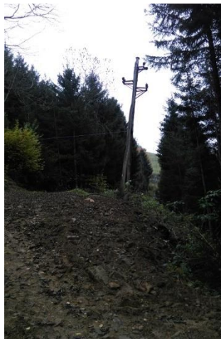
Slika 20 Od žleda poškodovan A-drog
