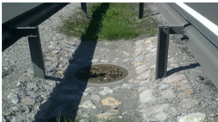
Slika 5: Jašek za odvodnjavanje (Vir: Lasten)
