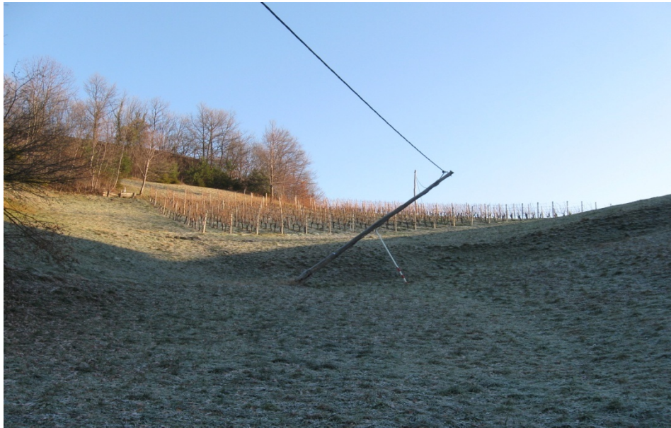
Slika 1: Podprt dotrajan drog (vir lasten)
