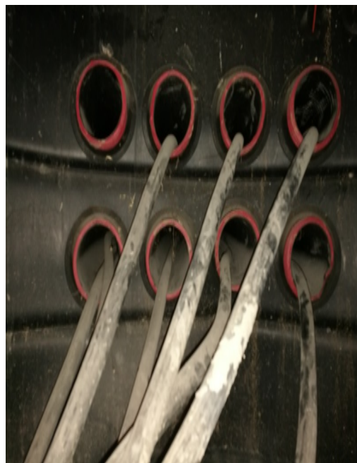
Slika 13: Cevna kanalizacija (Vir lasten)
