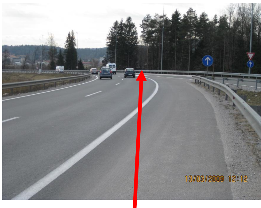
Slika 19: Točka, kjer so jeklene varovalne odbojne ograje zelo malo časa nepoškodovane
