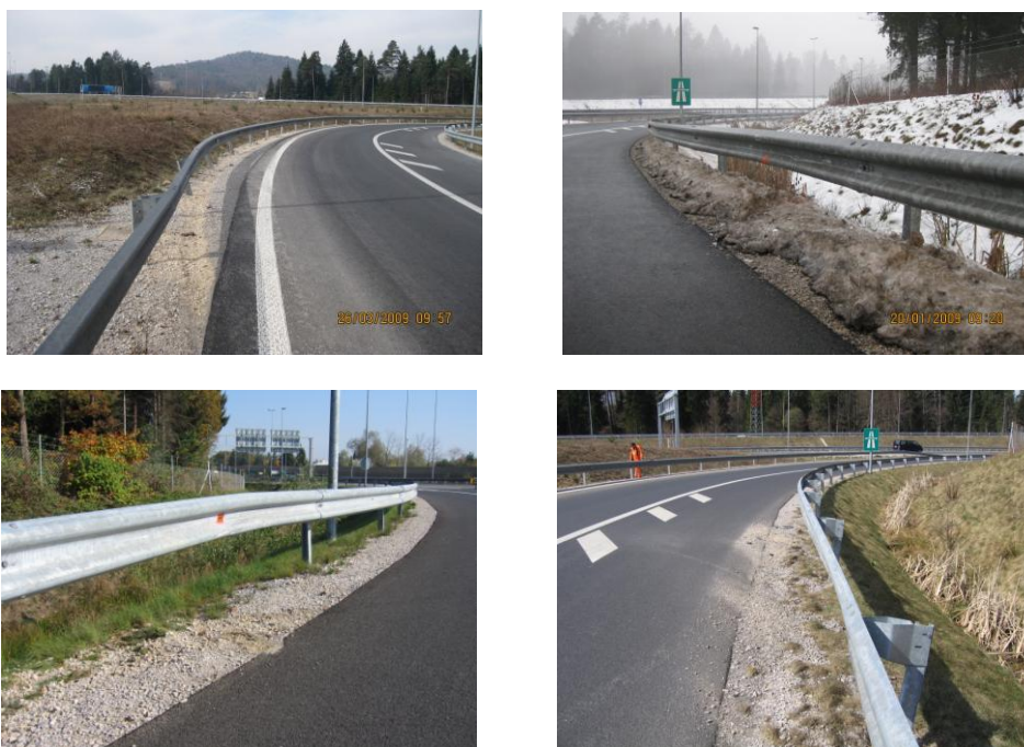
Slika 17: Nekaj poškodb odbojnih ograj v kraku B 0113 (vir DARS – baza Grič Lj)
