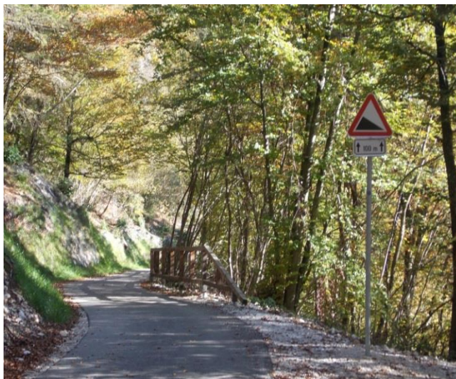
Slika 40: Nepravilno postavljen prometni znak Vir: Lasten (21. 10. 2012)
