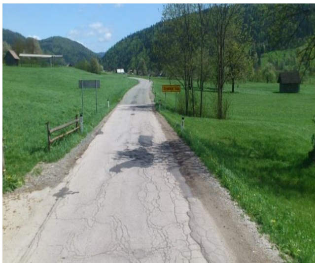
Slika 16: Slabo vzdrževana regionalna cesta R3-633 Vir: Lasten (3. 5. 2013)
