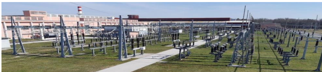
Slika 1: Stikališče 110 kV RTP Kidričevo (vir: lasten)
