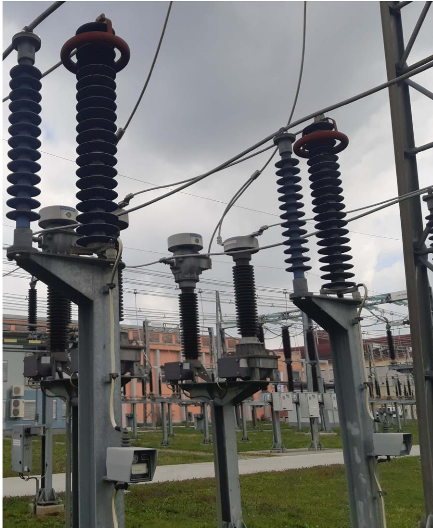
Slika 7: Odvodnik prenapetosti 110 kV (vir: lasten )
