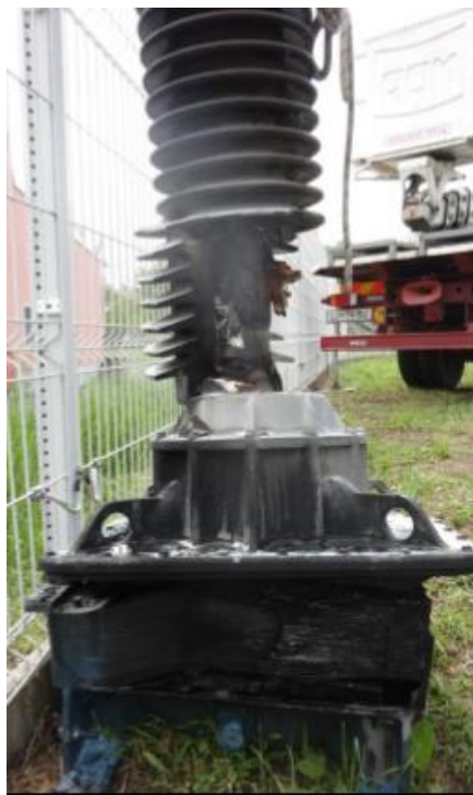
Slika 15: Stanje NIT po eksploziji (vir : Poročilo o eksploziji NIT v 110 kV TR polju v RTP 110/10 kV Kidričevo z dne, 28.4.2014 )
