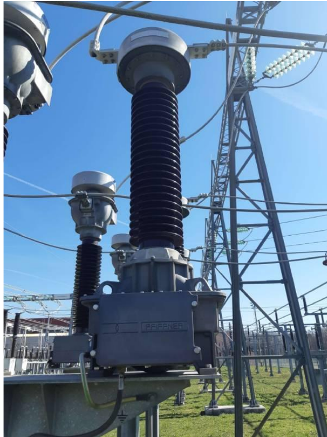
Slika 5: Napetostni instrumentni transformator 110 kV (vir: lasten)
