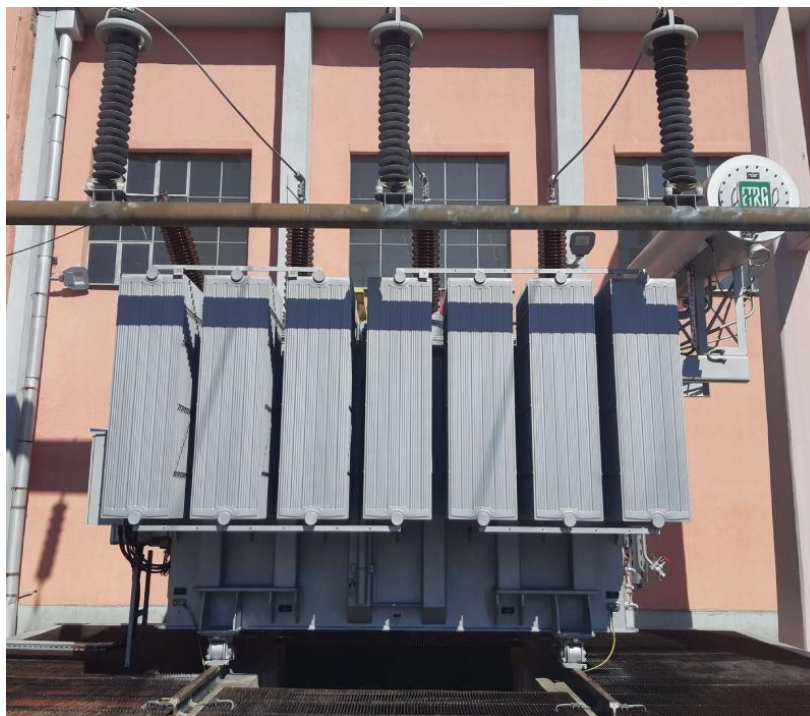
Slika 8: Trifazni energetske transformator 110 kV/10 kV L.2017 (vir: lasten)
