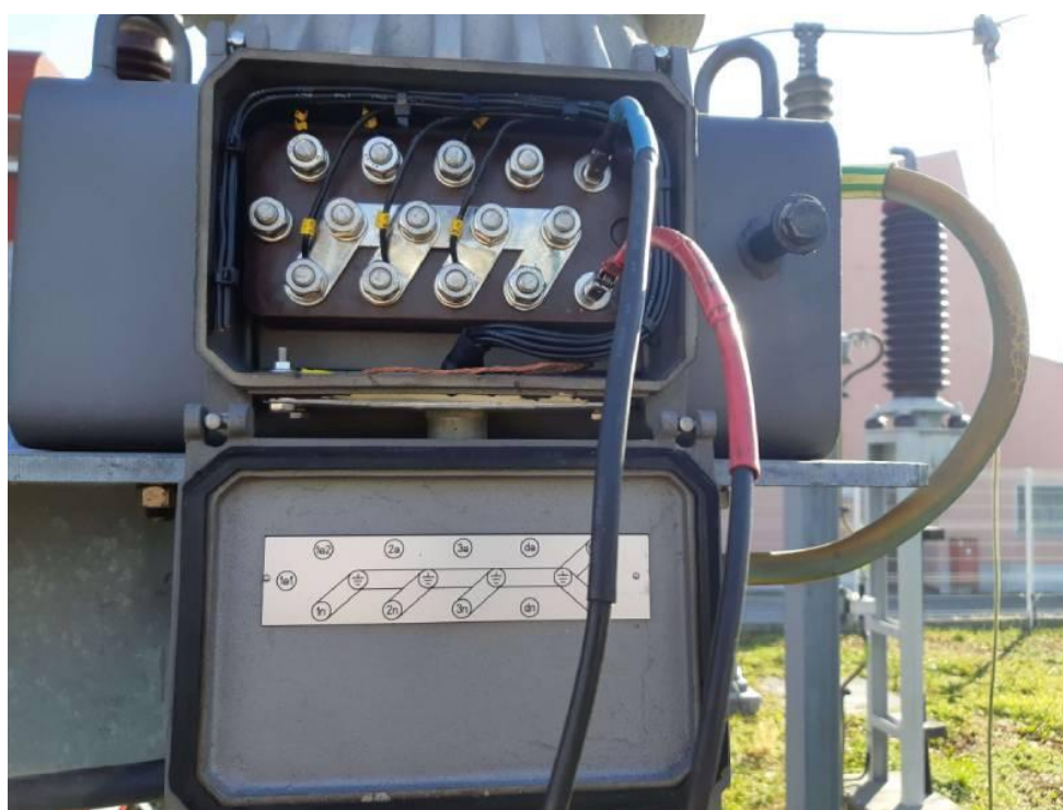
Slika 12: Priključna omarica instrumentnega transformatorja (vir: lasten)
