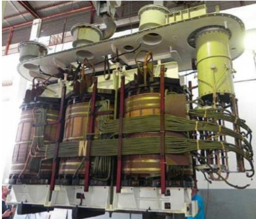
Slika 18: notranjost transformatorja in RGS
