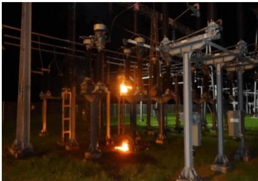
Slika 14: Požar na NIT v RTP Kidričevo (vir: Poročilo o eksploziji NIT v 110 kV TR polju v RTP 110/10 kV Kidričevo z dne, 28.4.2014)
