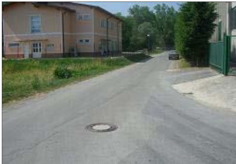
Slika 13: Pomanjkljivosti v križišču Industrija usnja Vrhnika-Mirke (Vir: Fakulteta za gradbeništvo in geodezijo, 2006)
