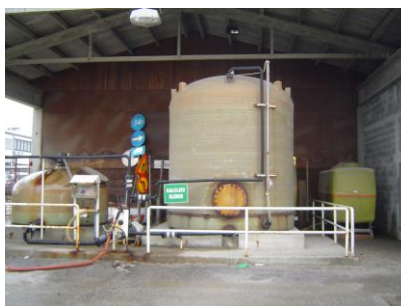
Slika 40: Skladišče kalcijevega klorida
