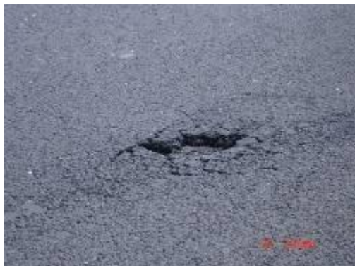
Fotografija 4: Razpoka na cestišču Vir: Lastni
