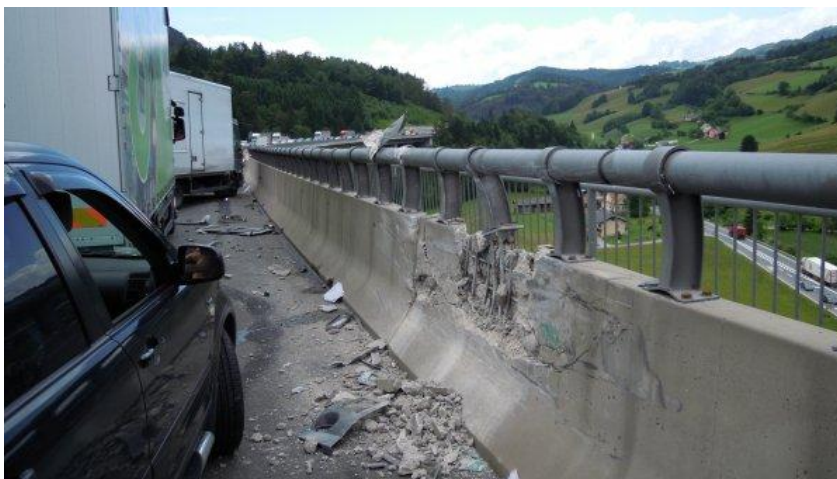
Slika 40: Primer silovitega trčenja tovornega vozila v betonsko varnostno ograjo
