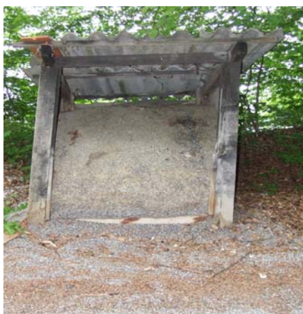
Slika 4: Zabož za skladiščenje peska (Vir: Lastni posnetek, 2007)
