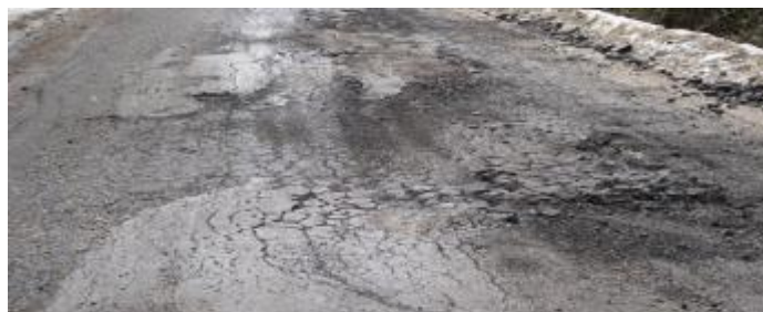
Slika 1: Poškodovana cesta zaradi vpliva nizkih temperatur (Vir: Domitrović, 2013)
