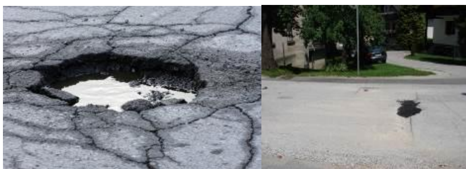
Slika 2: Udarna jama in primer sanacije (krpa)
